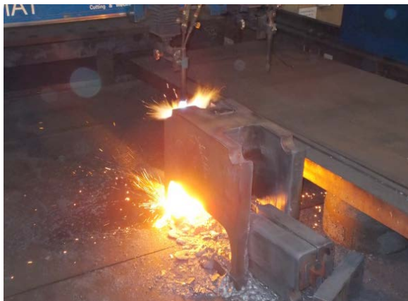
Image 3: Sans aucune opération de fraisage, le spécialiste en oxycoupage a réalisé ces formes complexes uniquement au chalumeau exactement comme le demandait le client.
